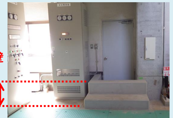
納所排水機場（多久市）
