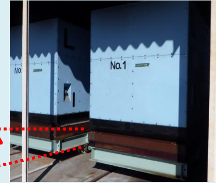
西今宿排水機場（佐賀市）
