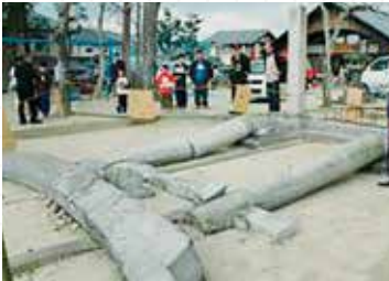
平成17年福岡県西方沖地震 鳥栖市 佐賀新聞社提供
