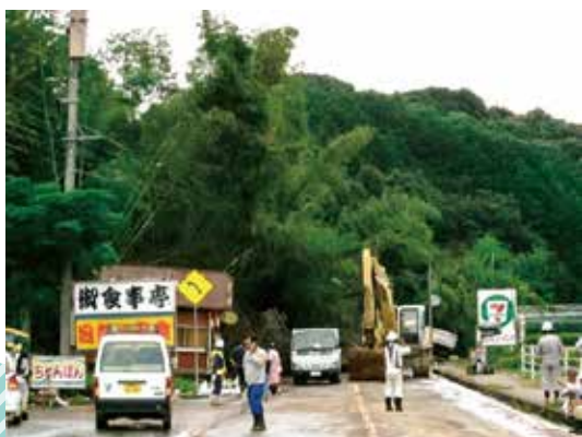
平成 18 年の大雨では、南波多町の府招地区で大規模な土砂災害が発生しました
