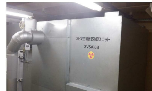
【3B安全補機室冷却ユニット】 14
