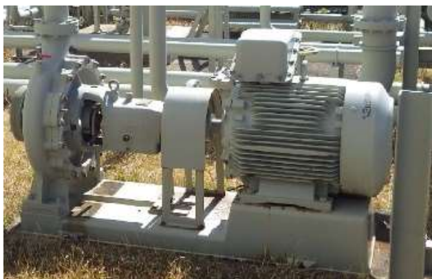
【スクリーン洗浄ポンプバックアップポンプ】
