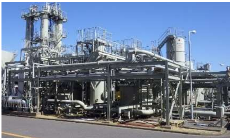
【補給水処理設備】
