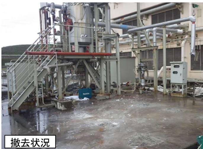
蒸気発生器ブローダウン 熱回収装置
