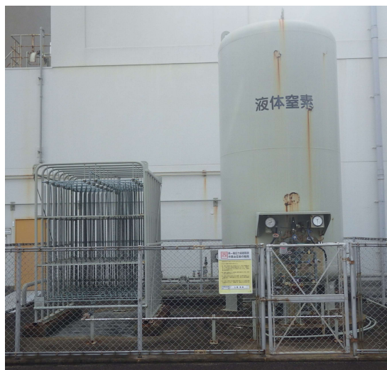
【液体窒素供給装置】
