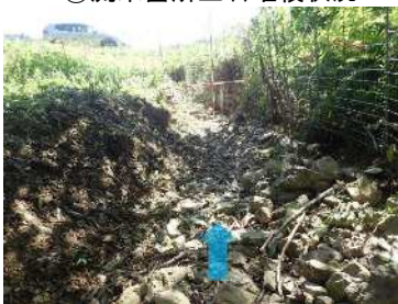
① 流末箇所土石堆積状況
