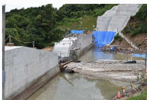
R3.8.15 土石流補足後
