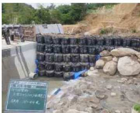
R3.7 土石流発生前
