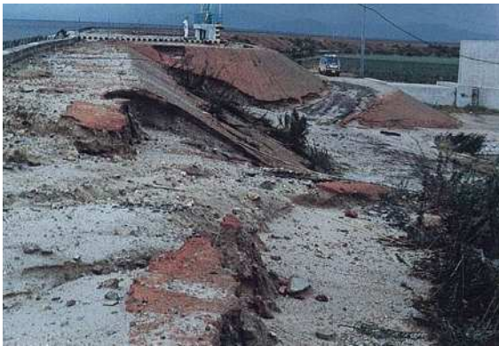
越波により流出した堤防盛土
