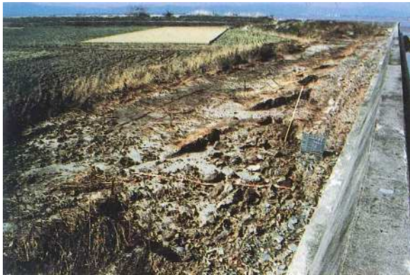
越波により流出した堤防盛土
