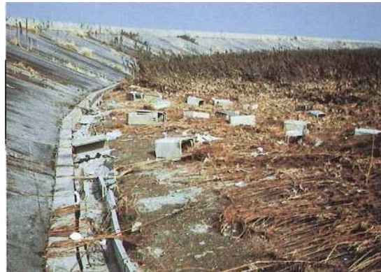
越波により破損した排水溝
