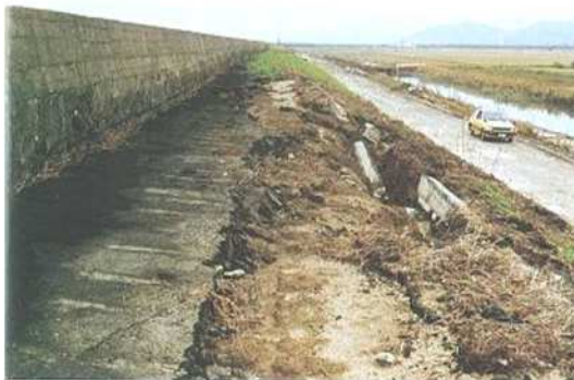
越波により流出した堤防盛土
