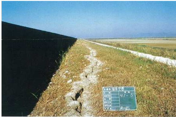
堤防盛土の亀裂
