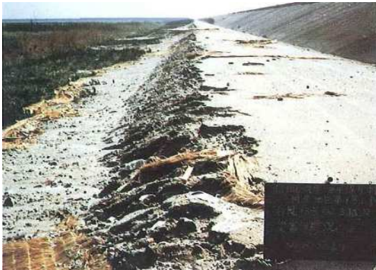
越波により流出した堤防盛土
