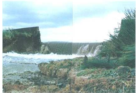
決壊した堤防
