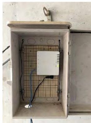
【坑内にWi-Fiルーターの設置(@100m)】
