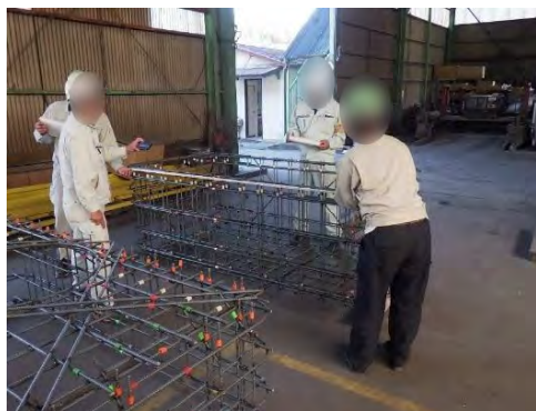
【立会状況（特殊部配筋）】
