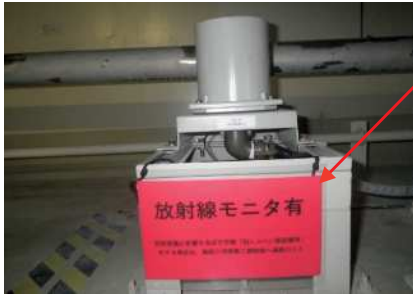
モニタを設置している架台
