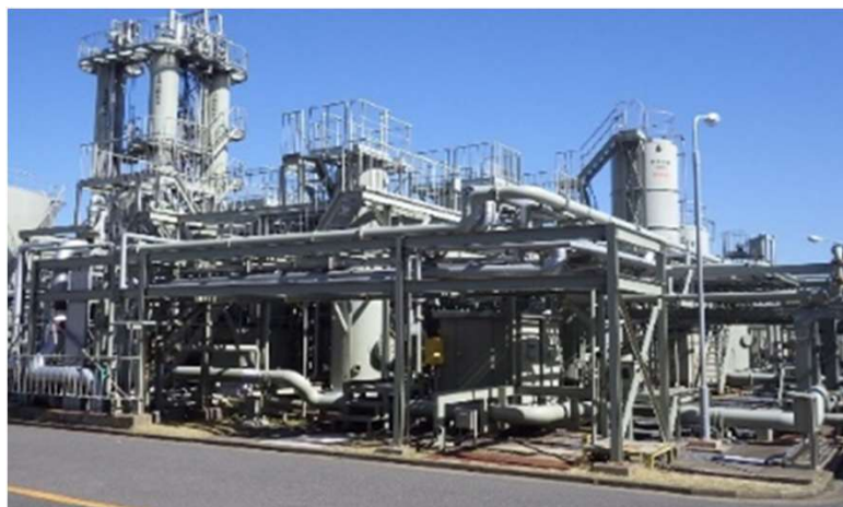
補給水処理設備
