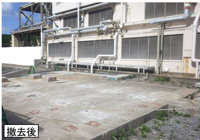
蒸気発生器ブローダウン 熱回収装置
