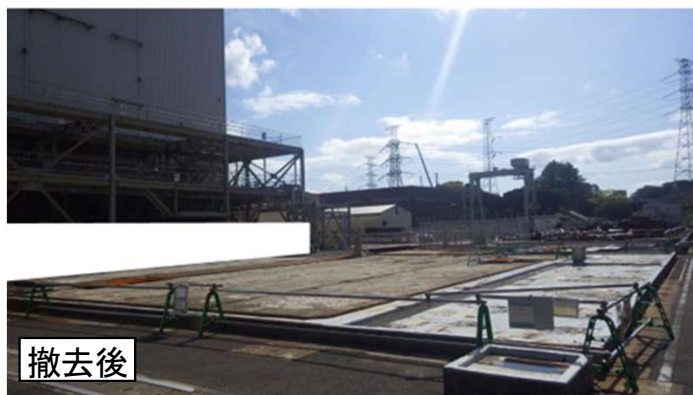
復水脱塩装置 (中和槽・排水槽排水設備含む)
