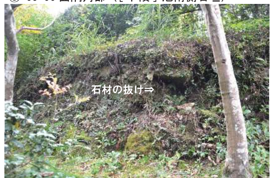
⑧ 10 面築石部 (下段庭園南面石垣) 変形箇所
