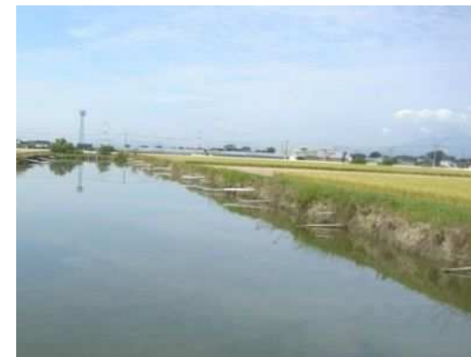
崩壊したクリーク法面
