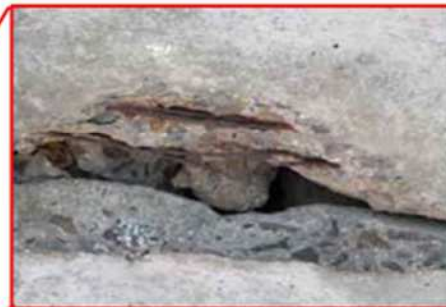
コンクリート剥落
