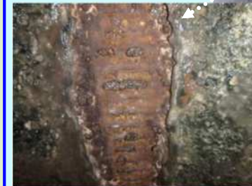
鉄筋の露出・腐食
