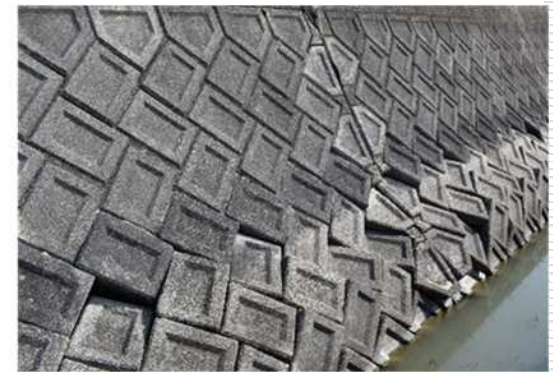
護岸（飛沫水路）の破損状況
