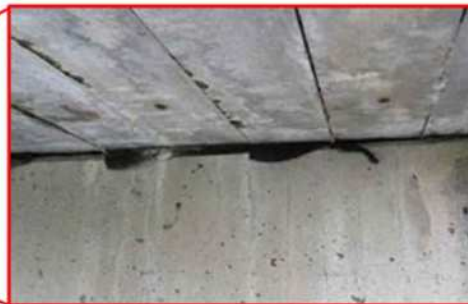
支承部の劣化
