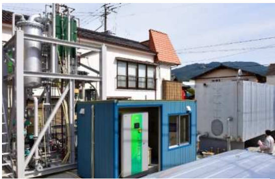
【温泉発電システムの実証試験環境】
