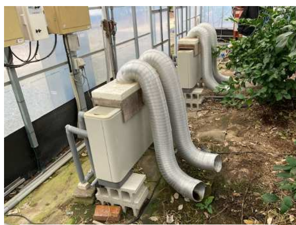
【ハウス内ファンコイルユニット】
