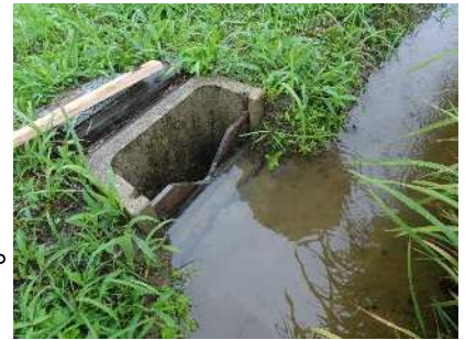
田んぼダム設置状況
