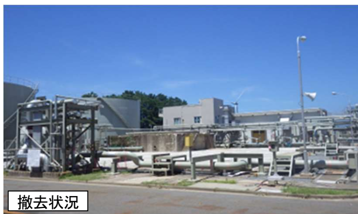
補給水処理設備
