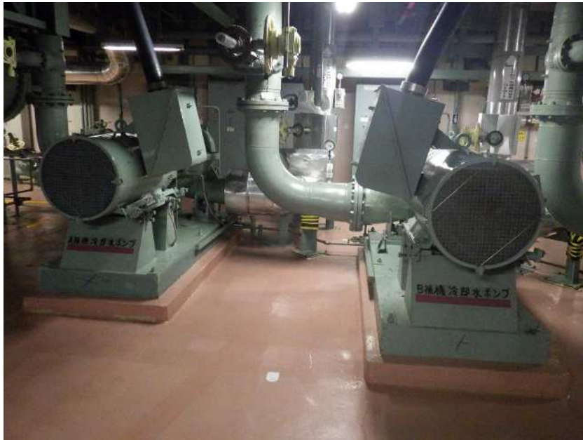
【原子炉補機冷却水ポンプ】
