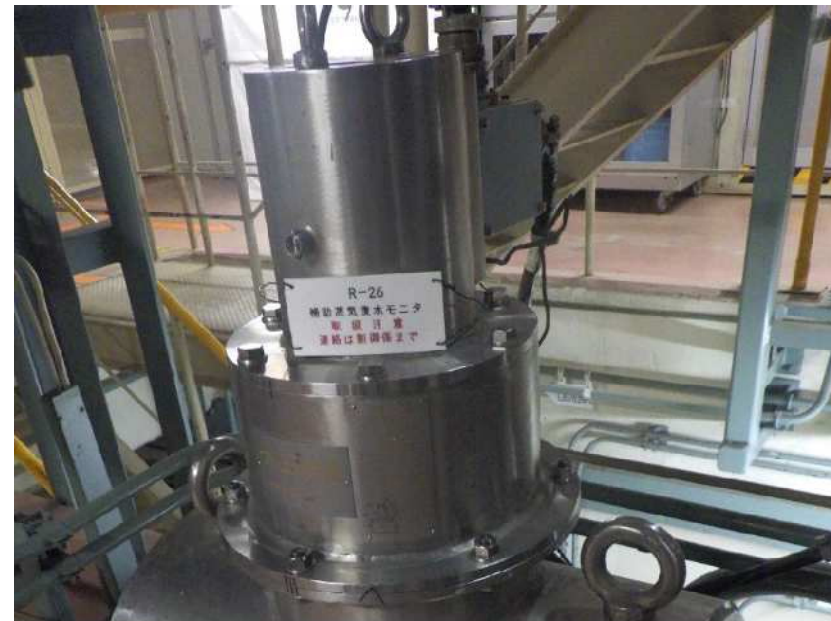
【補助蒸気復水モニタ】
