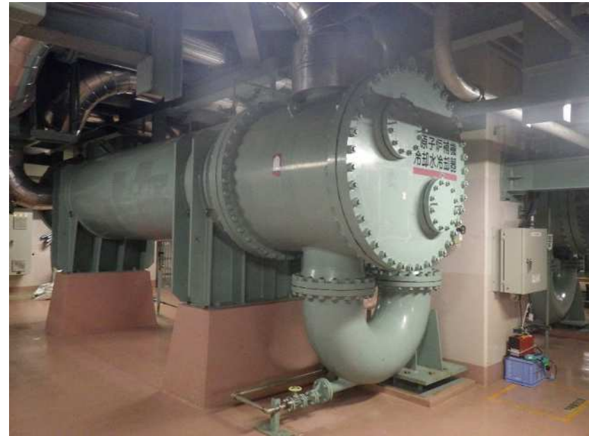
【原子炉補機冷却水冷却器】
