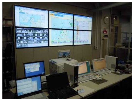
テレメータ中央監視局（環境センター）
