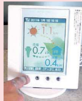
発電モニターには発電量や消費電力が表示されます。省エネにチャレンジ!!
