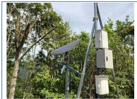
【スターリンク(衛生通信機器)】
