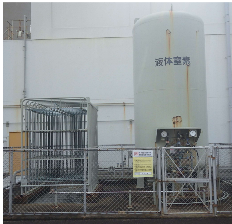
液体窒素供給装置
