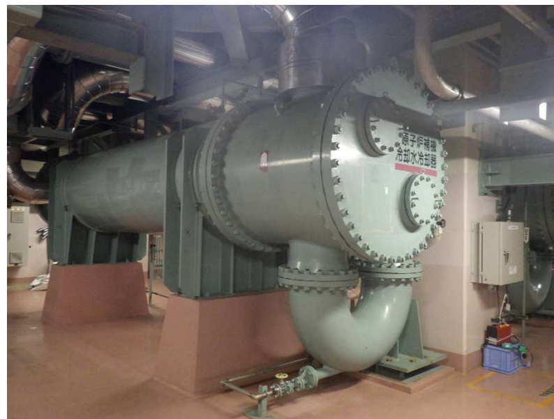
【原子炉補機冷却水冷却器】
