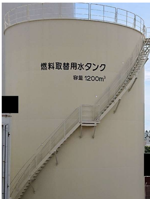
【燃料取替用水タンク】
