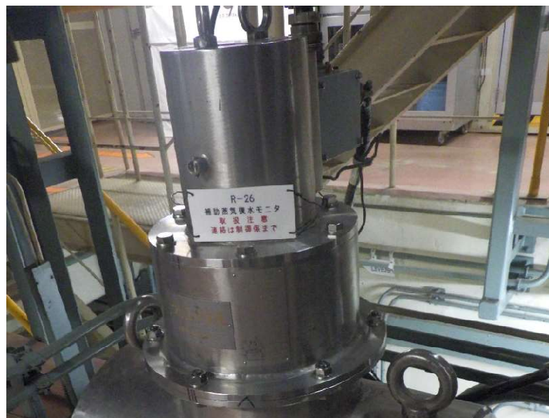
【補助蒸気復水モニタ】
