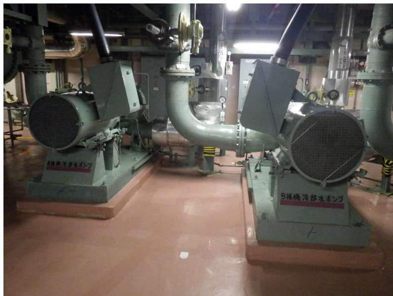
【原子炉補機冷却水ポンプ】
