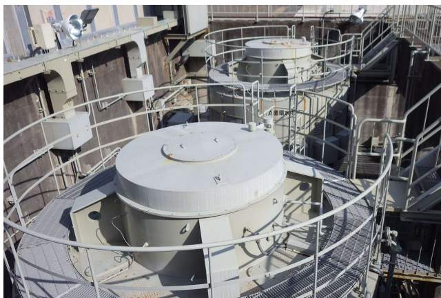
循環水ポンプ
