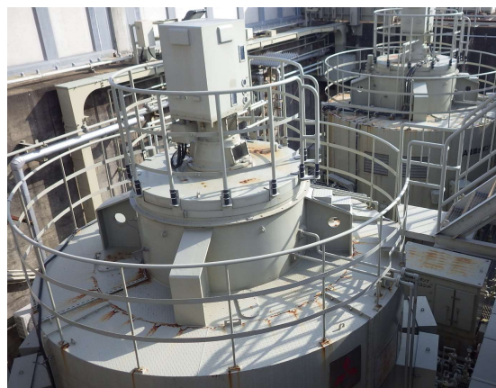
循環水ポンプ
