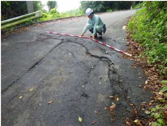
市道に発生した亀裂
