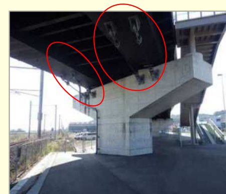
落橋防止装置
