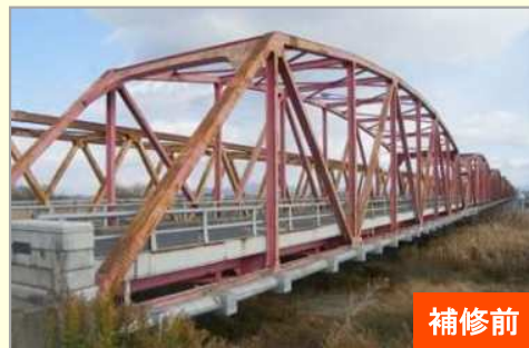
<補修事例> 六五郎橋 (主要地方道 佐賀八女線)
