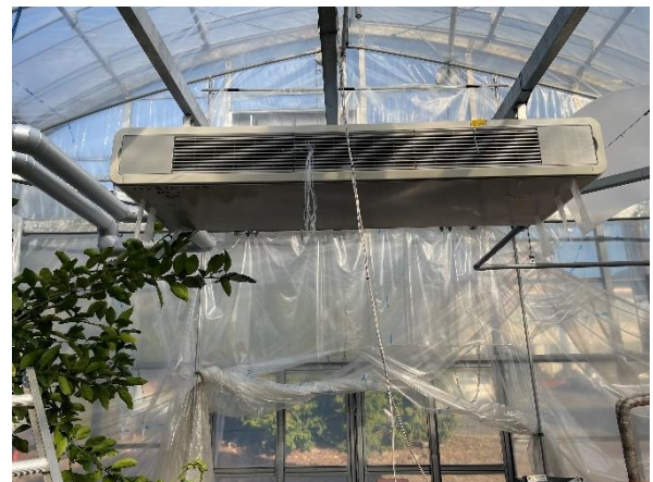
【ハウス内ファンコイルユニット】
