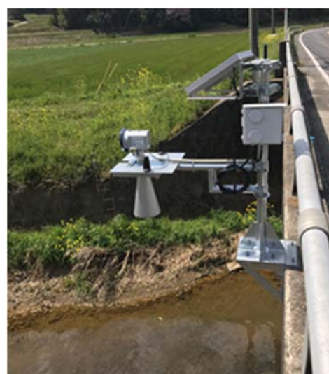
写真 6.4 河川水位情報の提供（水位計）
