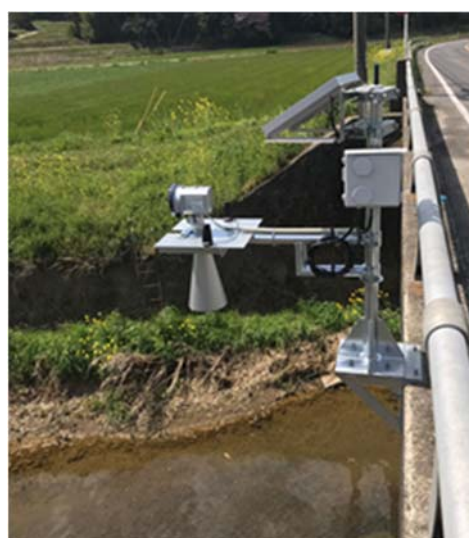
写真 6.4 河川水位情報の提供（水位計）
