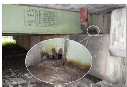
損傷内容：主桁端部・支承の腐食
