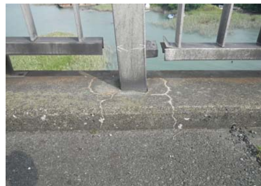
防護柵の破断例
