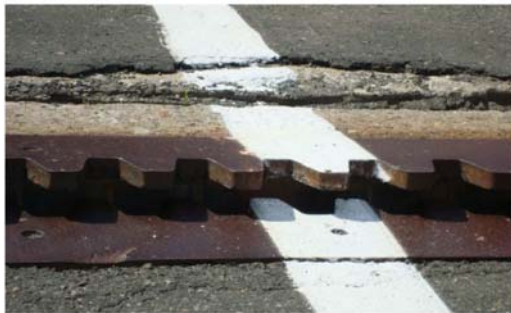
伸縮装置部の過大な段差例
