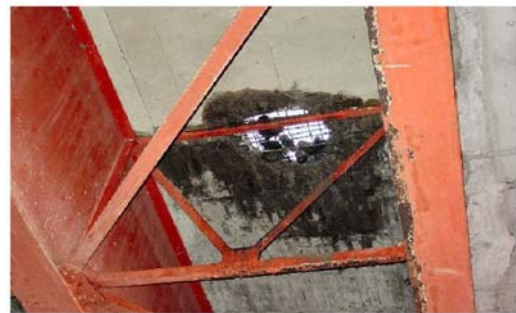
コンクリート床版の抜け落ち例
