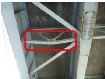
部材の異常変形例
