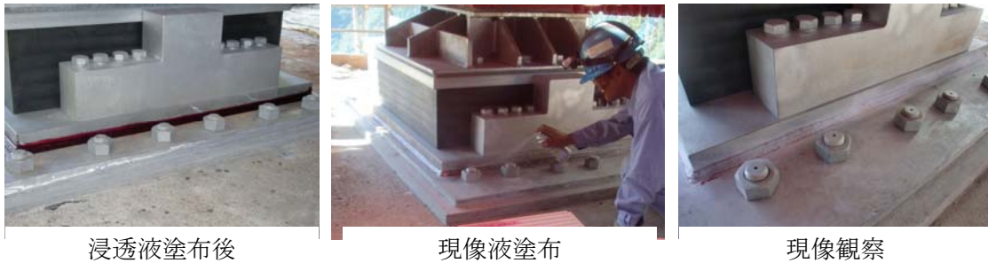
写真 3-1-27 浸透探傷事例
