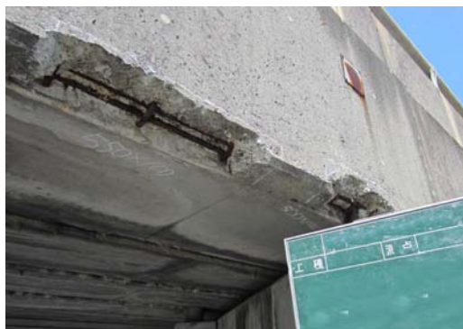
交差道路上のコンクリート剥離例
