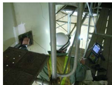
写真 3-1-26 超音波探傷事例
