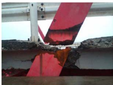
写真 2-2-1 トラス橋の弦材破断
