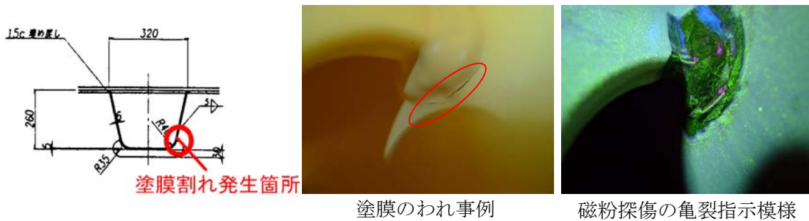
写真 3-1-25 塗膜のわれから磁粉探傷を実施した事例
