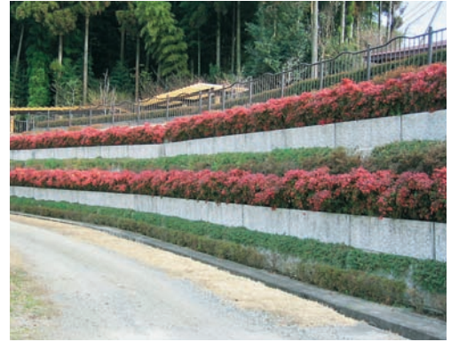
擁壁を段上とし、緑化することにより、圧迫感が軽減されている。(みやき町)
