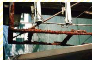
袖看板の底部脱落
