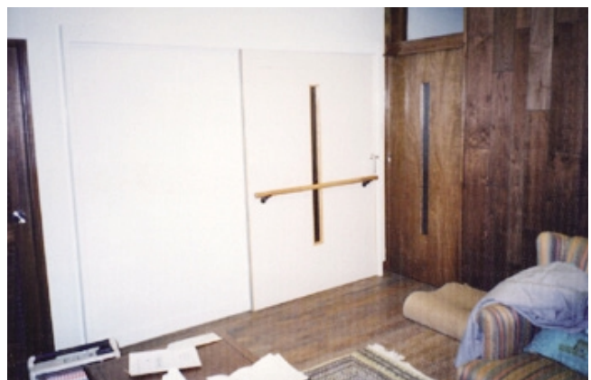
居間の扉が閉まった状態のときにも、つかまる所が必要なので、手すりを設置した
