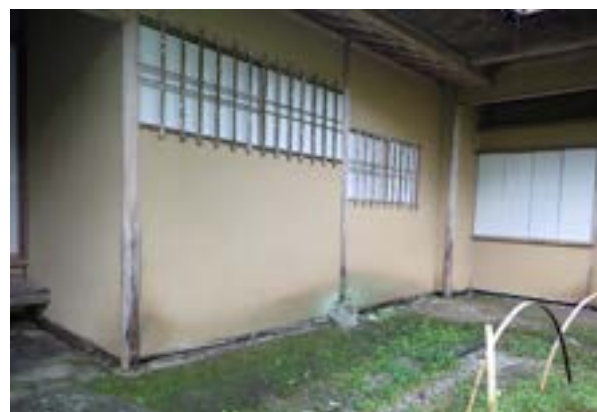
図3-1-29 染みがみられる土壁
