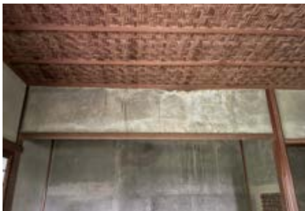
図3-1-26 雨漏りによる染み
