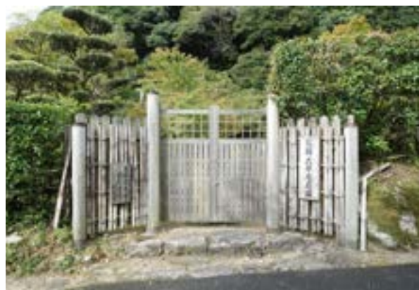
図3-1-32 老朽化により部分的に破損、看板の題字の色褪せ
