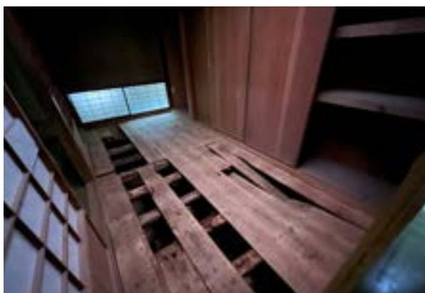
図3-1-28 破損がみられる床板
