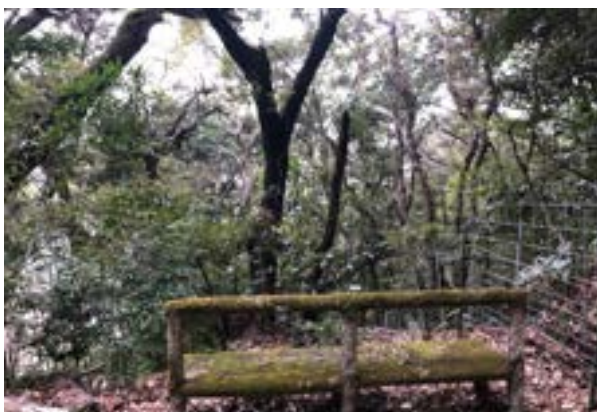
図3-1-24 ベンチの老朽化、眺望を遮る樹木
