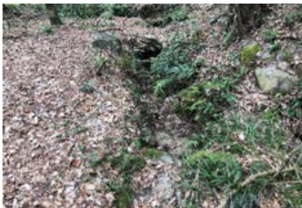
図3-1-13 石組が不明瞭になっている水路
