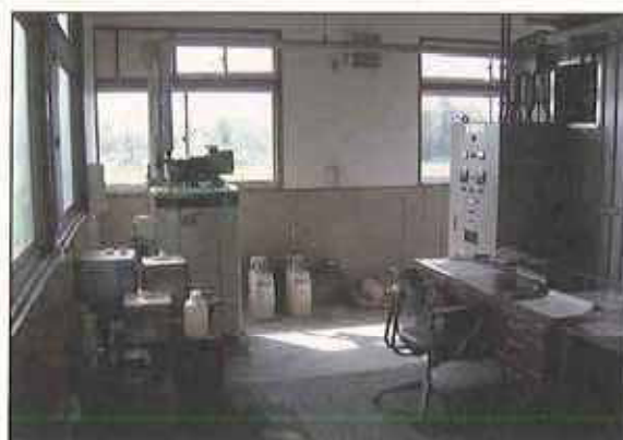
ボイラーと温度制御盤
