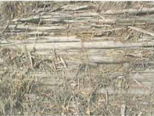
施工後12年経過（形が崩れつつある。）
