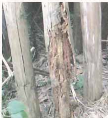
施工後10年の腐朽状況
