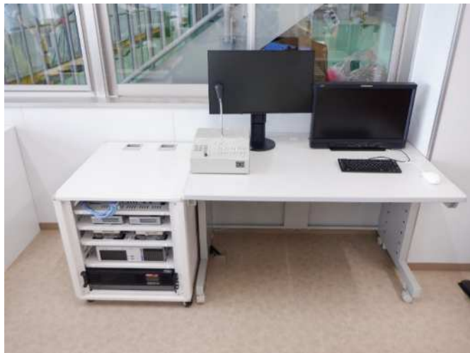
(航空隊庁舎の副統制局設備)
