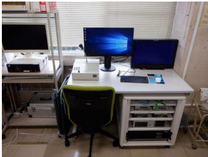
(唐津総合庁舎の副統制局設備)
