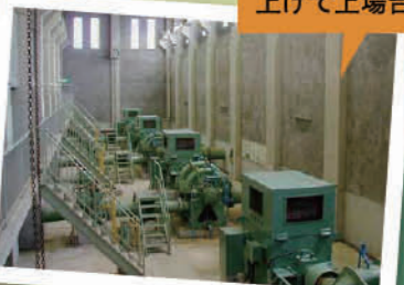
揚水機場の中(ポンプ)のようす
