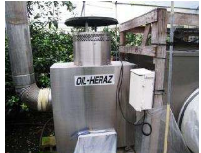
排熱回収装置
