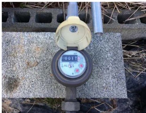
図8 水量計の設置
