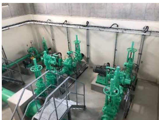
[整備した揚水機]
