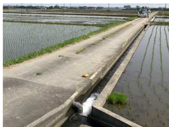
[分水口からの給水状況]
