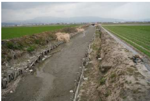
[水位変動により法面崩壊]
