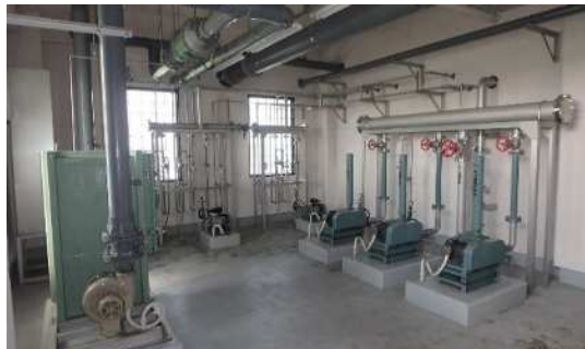
[農業集落排水施設の内観] (佐賀市江戸地区)
