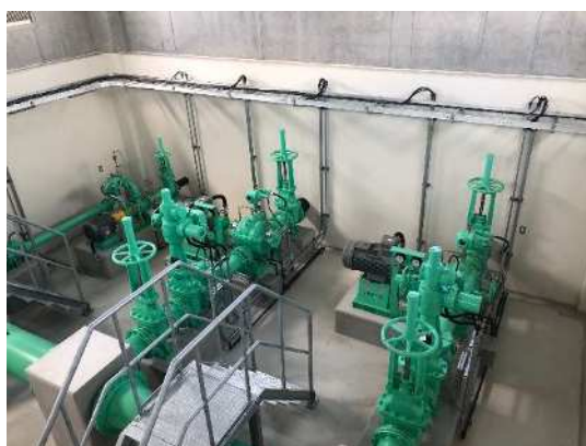
[整備した揚水機]
