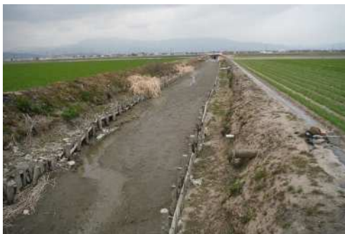
[水位変動により法面崩壊]
