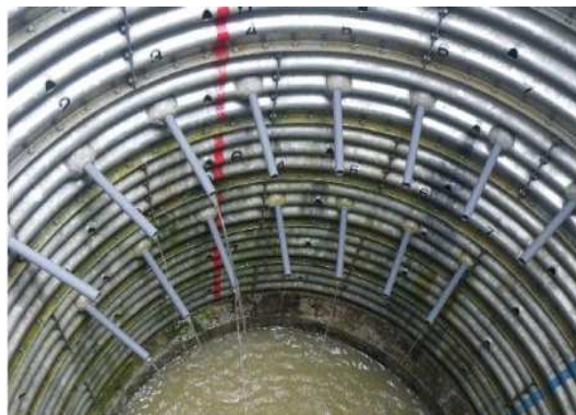
〔集水井内の水抜き状況〕
