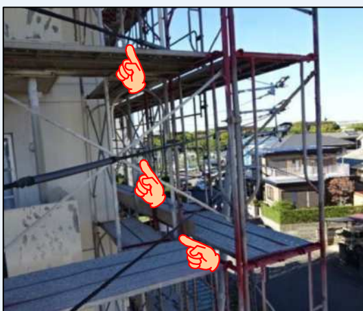
【足場が高圧線を貫通】
