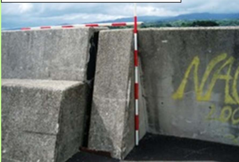
不等沈下による打ち継ぎ目部のずれ(七浦地区)
