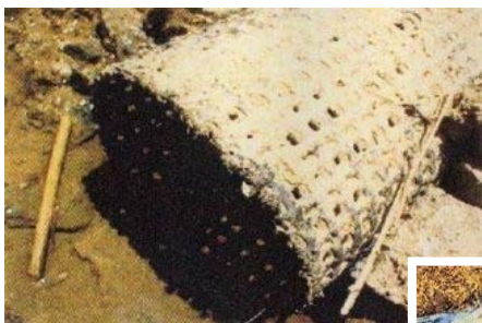
△ 変形し目詰まりした排水管
