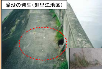
陥没の発生(廻里江地区)
