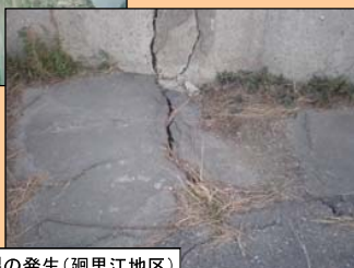
不等沈下による亀裂の発生(廻里江地区)
