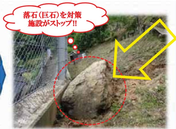
落石発生後（近景）
