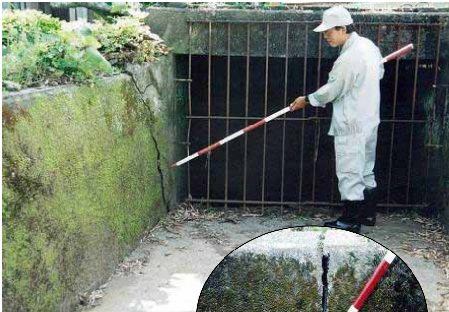
亀裂が入った 農業用水路
