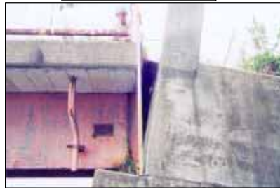
橋梁の被害状況
