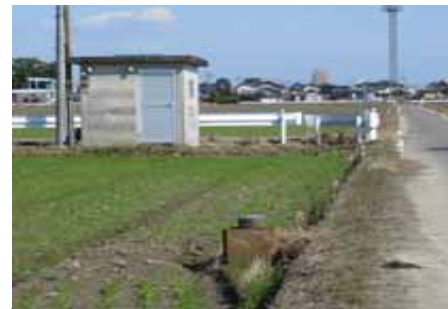
整備された用水路 （用水ポンプ、給水栓）
